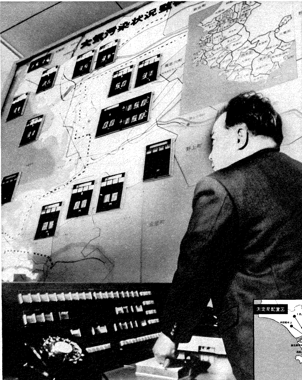
昨年8月から建設をすすめていました「テレメータースシステムによる大気汚染監視装置」が完成。 大橋知事が始動のボタンを押し、本格運転を開始しました。
